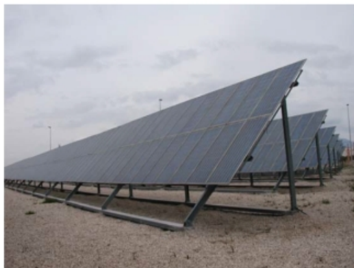
Figura 4. Vista general de la planta solar fotovoltaica de la Universidad de Alicante.
