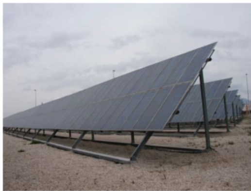
Figura 4. Vista general de la planta solar fotovoltaica de la Universidad de Alicante.
